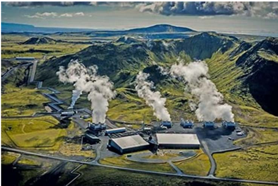
Abb. 9: Luftaufnahme einer Direct Air Capture (DAC) Anlage in Island. Quelle: https://climeworks.com/ .
